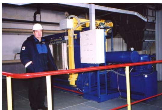
Фильтр-пресс ЧМ 32/25-800, ТЭЦ-27, «Мосэнерго», г. Мытищи
