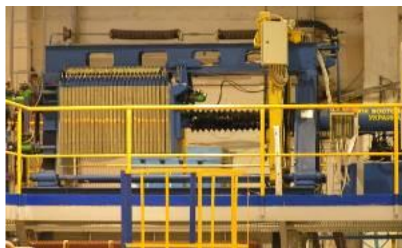
Фільтр-прес ЧМ 25/15-800, Балтійська ТЕЦ, м. Нарва, Естонія
